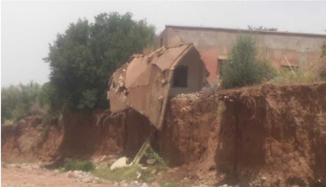
Figure 28: Habitation effondrés lors de la crue de 2014
