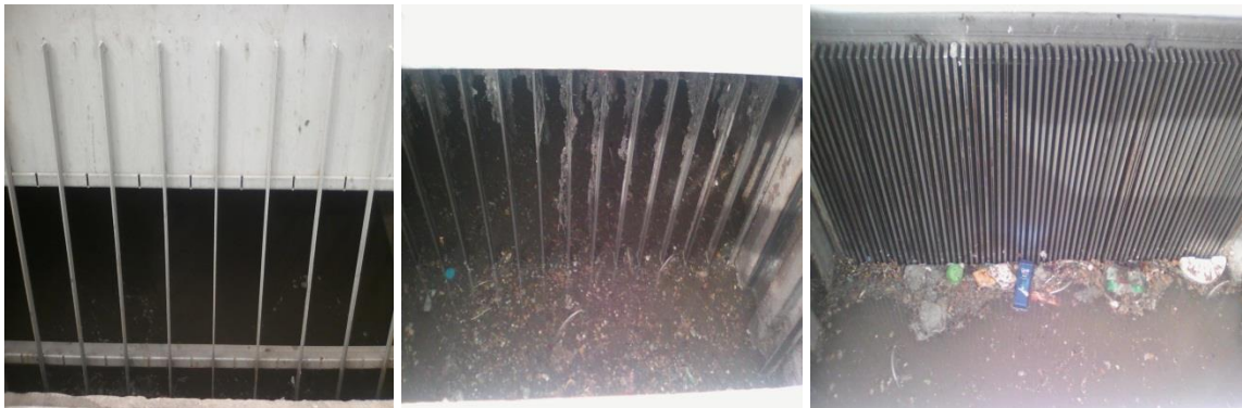
Figure 7 : Pré-dégrillage, dégrillage grossier et dégrillage fin
