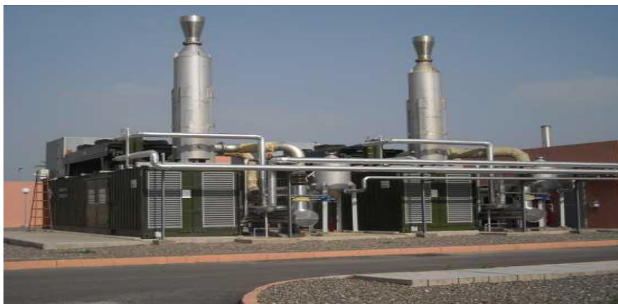
Figure 19 : Cogénération de gaz.
