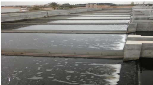
Figure 13 : Filtres à sable
