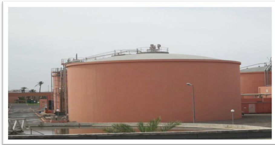
Figure 15 : Le digesteur de la STEP de Marrakech
